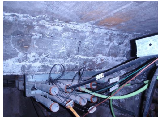
写真1 妙高大橋 PC 箱桁内部劣化と各種センサー計器等やファイバー状センサーによるモニタリング状況
